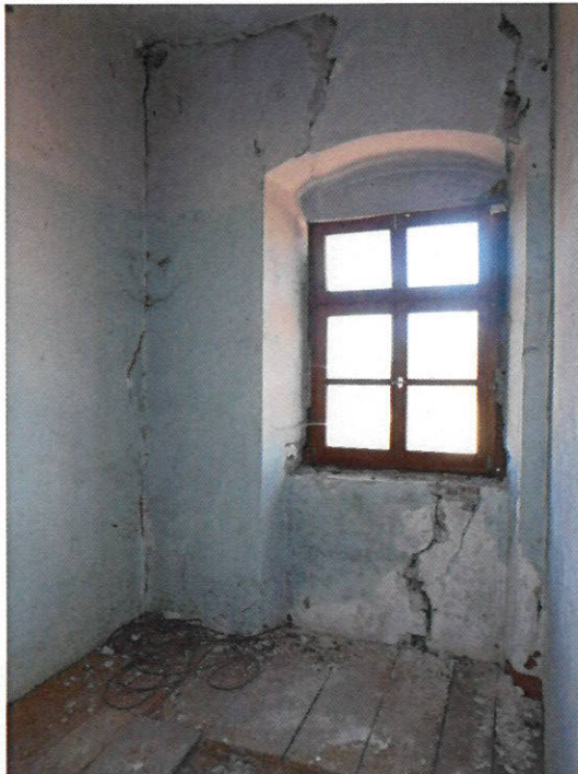
Mauerwerksriss Außenfassade Nord
