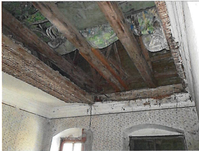
Untersicht „Mann-an-Mann-Decke“ und Zerrbalkenlage mit erheblichem Ausbruch
